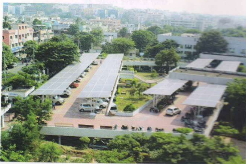
विशाखापत्तनम में नगर निगम के पार्किंग स्थल की छत पर सोलर इन्गल्टी
